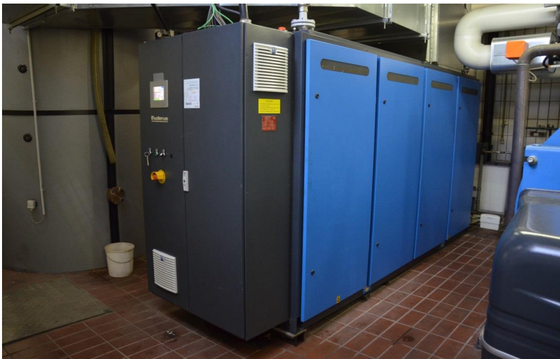
BHKW im Schallschutzgehäuse
