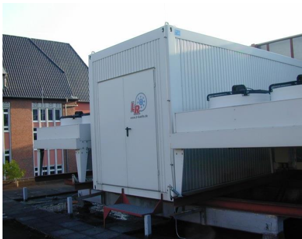
Kälteanlage im Schallschutz-Container
