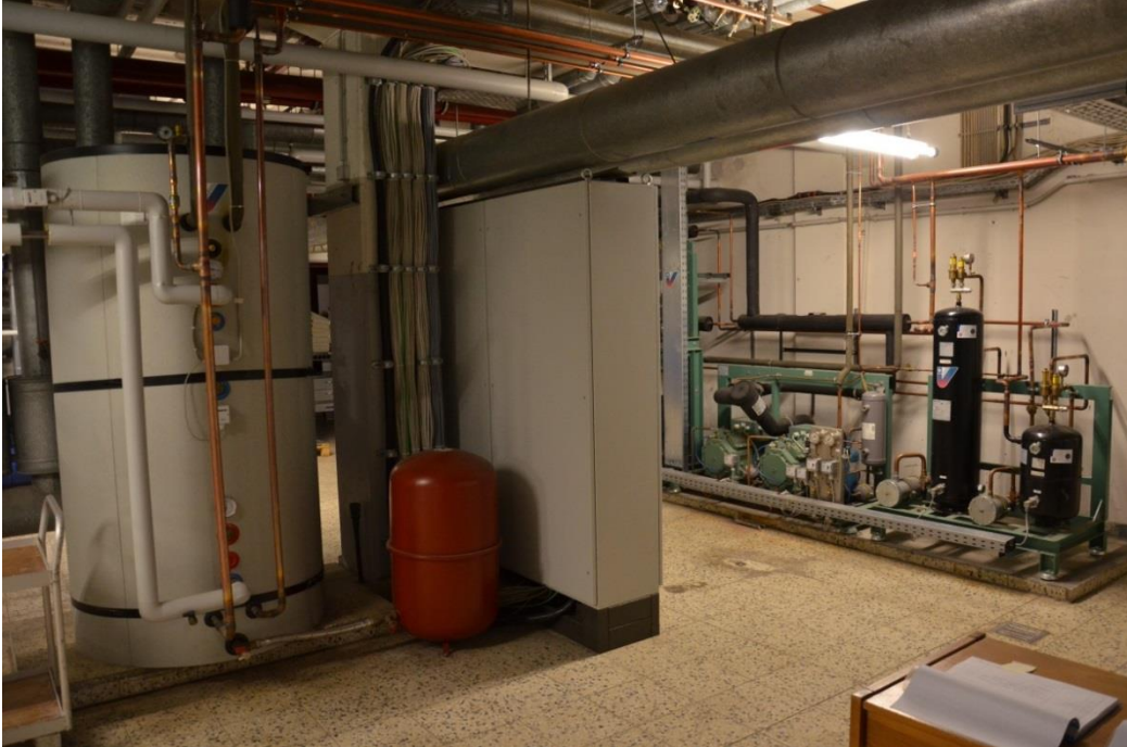
Kälteverbundanlage mit Wärmerückgewinnungs-Speicher
